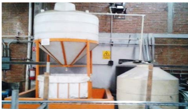
Figura 2. Planta tratadora de agua Fuente: Empresa Tubos Cromatizados MF
