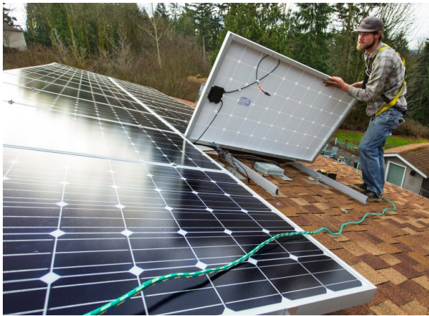
Figura 1.3 Ejemplo de una instalación fotovoltaica adaptada al tejado disponible. Fuente: (Bernton, 2015).
