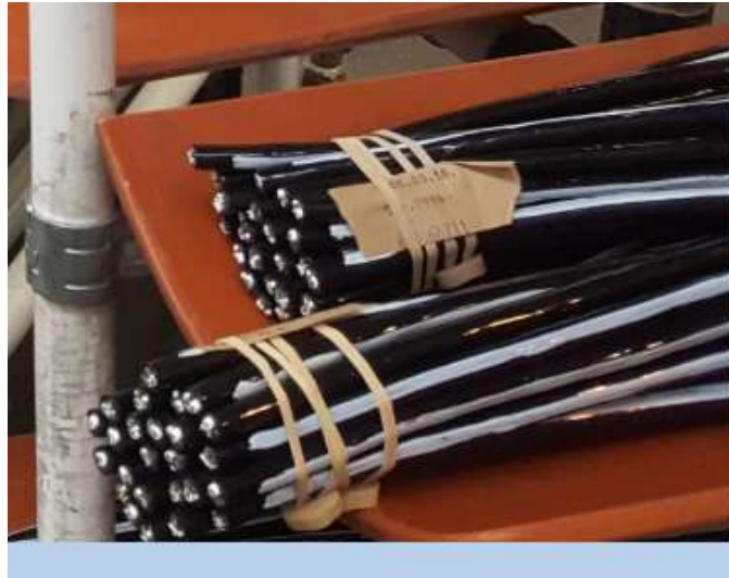
Figura 1.3 Cable multiconductor utilizado en la estación
