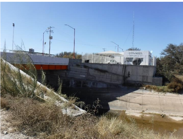
Figura 8 Zona de compuertas que derivan el escurrimiento hacia canal revestido de zona de riego relacionado al video de la Figura 7.
