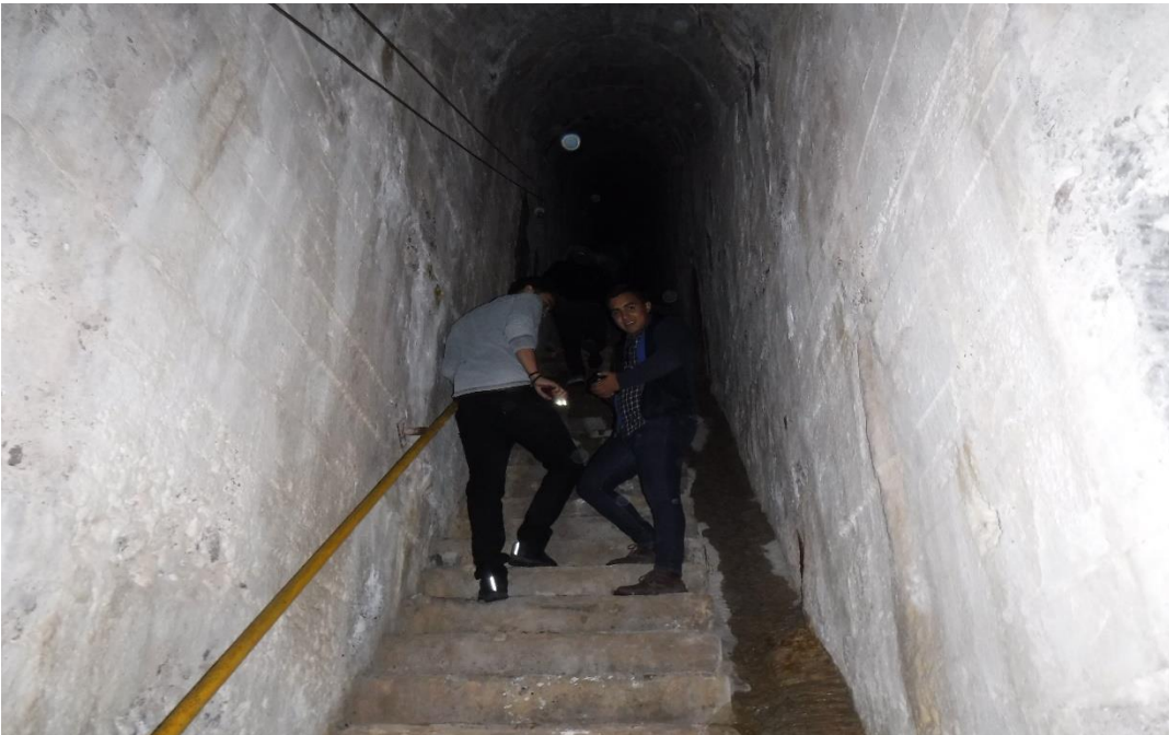
Figura 9 inicio túnel revestido de concreto con escalones, note el fondo oscuro
