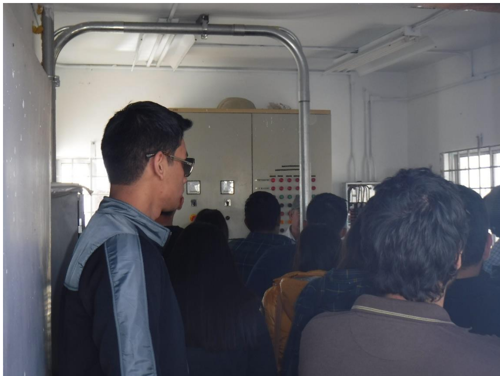
Figura 2 Cuarto de control de las compuertas reguladoras. Explicación del control de derivación de las compuertas durante los períodos de siembra en función de las necesidades de riego se programan de manera mensual según las necesidades de riego y de la temporada.
