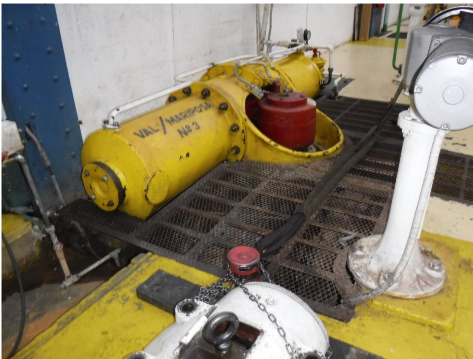
Figura 6 válvula tipo mariposa que distribuye el fluido a través del sistema de tuberías a las turbinas para generación de energía eléctrica.
