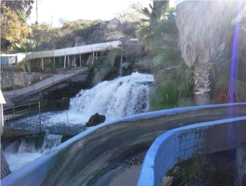
Figura 17 Cascada que se forma por agua filtrada por excedencias de presa Boquilla
