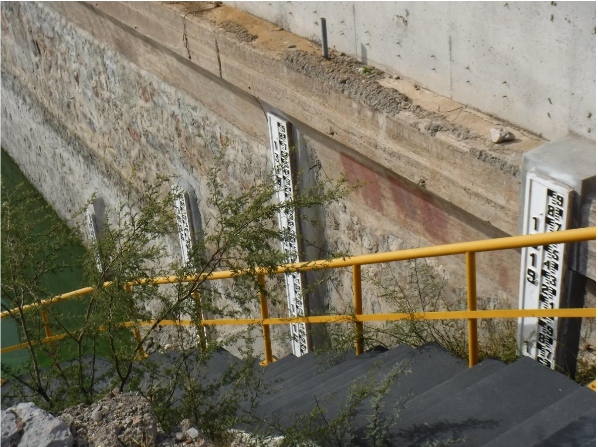
Figura 13 escalas para el monitoreo de niveles de operación, volumen de almacenamiento y gastos de diseño de la presa de irrigación y central Hidroeléctrica.
