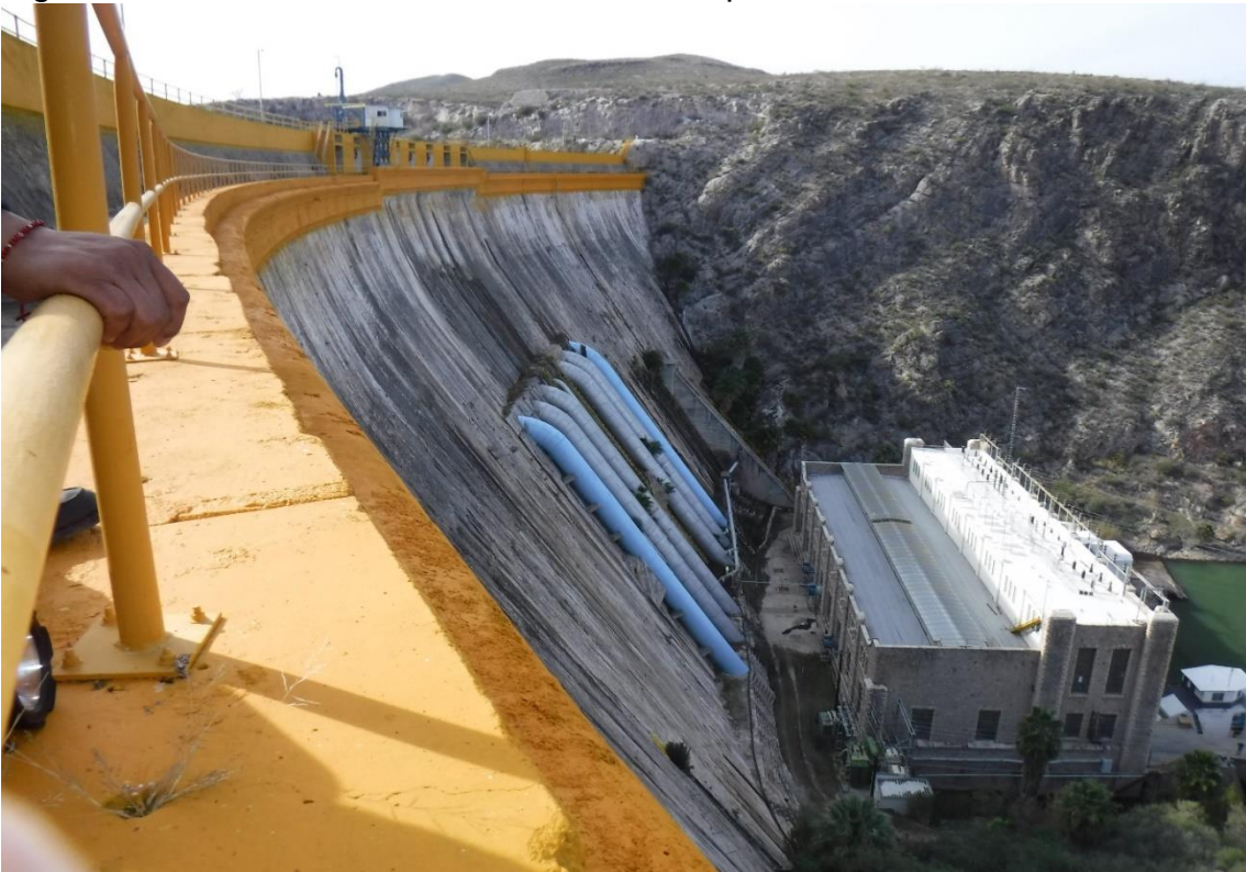
Figura 11 Vista Este de la cortina, 6 tubos de desfoque, cuarto maquinas y turbinas de central Hidro-eléctrica y maciso rocoso de anclaje de la cortina.
