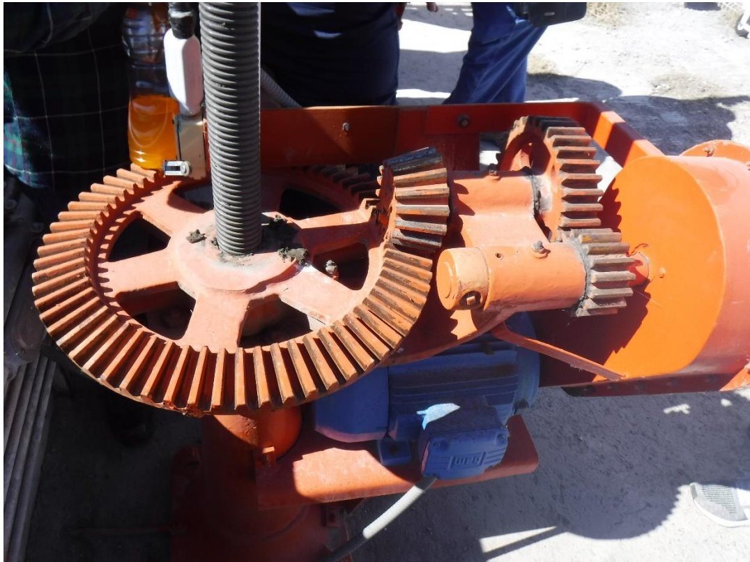
Figura 4 Se aprecia la base donde se controlan la apertura de compuertas a través de engranes, las escalas que se muestran al momento de subir o bajar estas de manera manual
