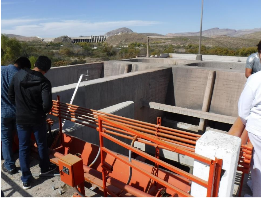
Figura 25. Vista superior de disipador de energía.
