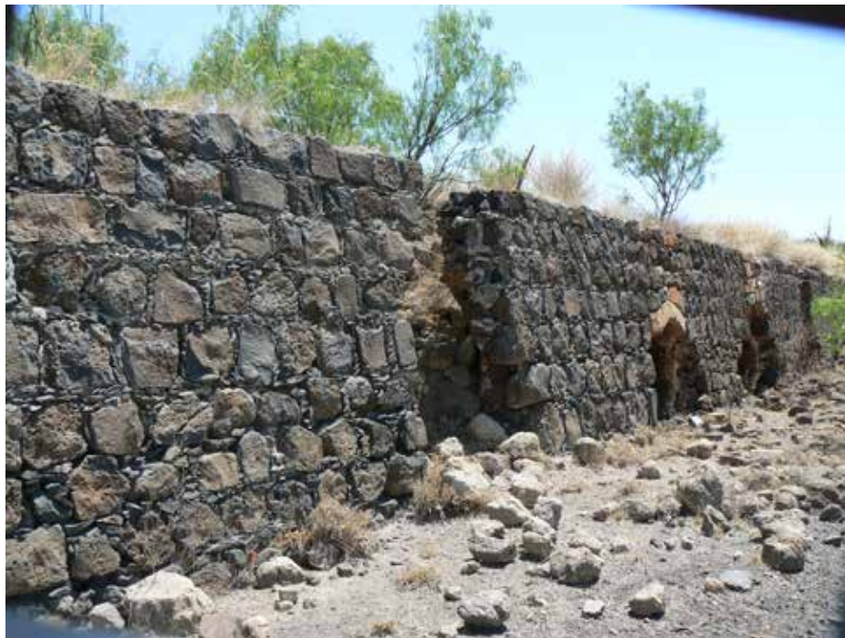
Figura 9. Estructura de hornos de colmena para coque (Coke Behive Oven), en El Hondo. Estas estructuras consistieron en dos partes: una se refiere a todas las piezas de ladrillo, para vanos de puertas y bóvedas, que en algunos casos se fabricaron en San Luis Misuri, y otra parte consiste en el relleno de tierra y obra de mampostería exterior. La gente en la región ha saqueado estos materiales para resolver sus necesidades de habitación. Fotografía del autor (2009).
