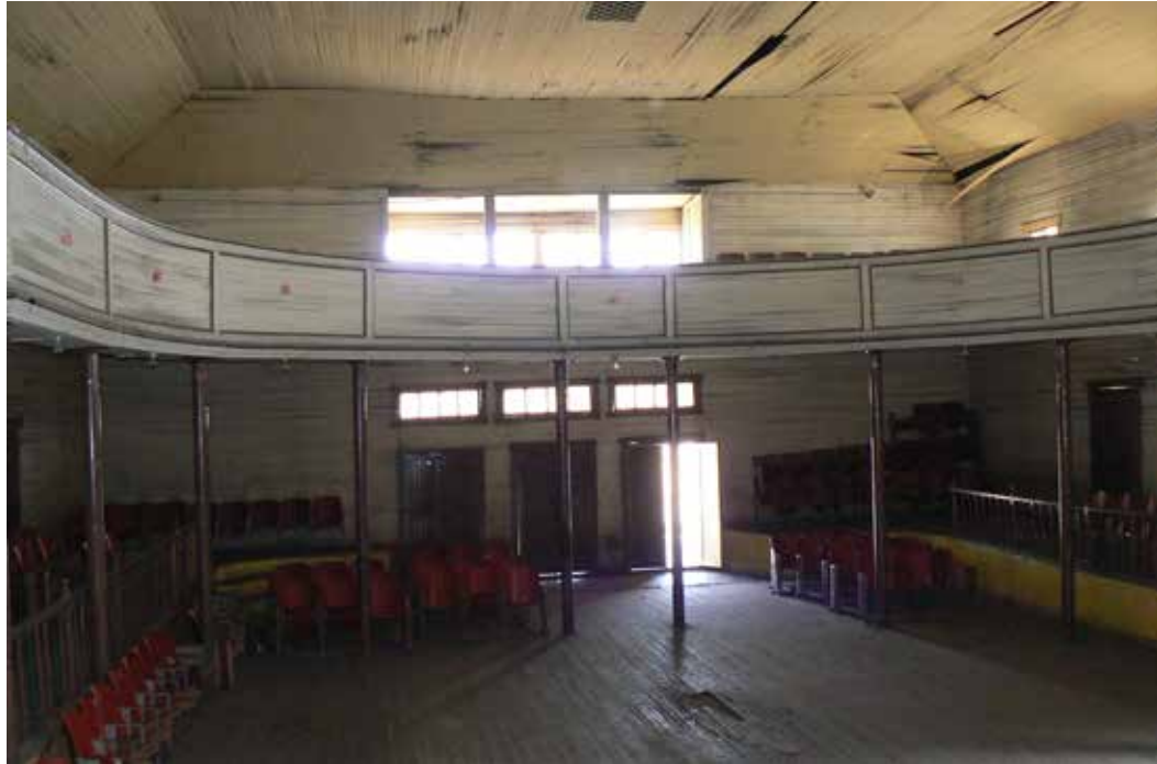
Figura 8. Interior del teatro del Mineral Las Esperanzas, establecido por la Mexican Coal and Coke Company , hacia 1900. Actualmente este tipo de edificios consolida la narrativa de la región carbonífera, y desde que los construyeron las primeras empresas, pasaron por otras etapas como el cooperativismo, la intervención estatal, y el nuevo régimen de apertura de recursos al capital privado en la última década del siglo XX. Fotografía del autor (2009).
