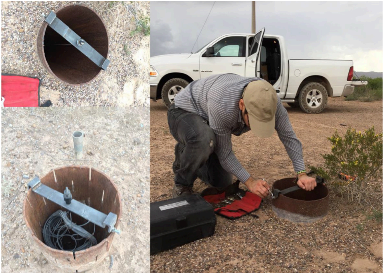
FIGURA 7: Instalación de piezómetros digitales sobre la infraestructura del pozo (Romero-Gameros, 2018).
