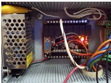
Figura 5. Cableado del PLC. Fuente: Elaboración propia.
