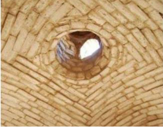
Imagen 6. Luis Guerrero. Interior de bóveda de adobe, Proyecto San Isidro, Tlaxco, Tlaxcala México. Recuperado de: https://editorialrestauro.com.mx/gremium/index.php/gremium/article/view/3
