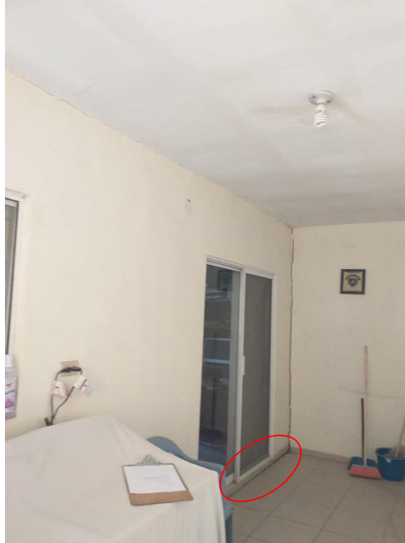
Figura 6 Separación de piso del cuarto de lavado (lado este) con piso de sala de estar
