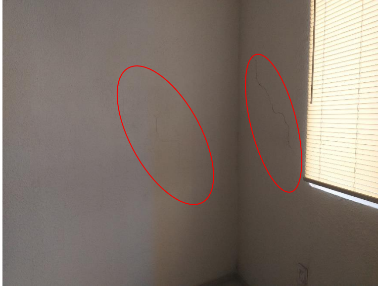
Figura 7 Muros interiores de caras norte y oeste del cuarto de lavado, con grietas
