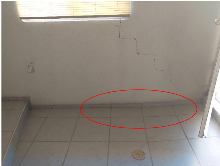
Figura 4 Piso terminado del cuarto de lavado con asentamientos
