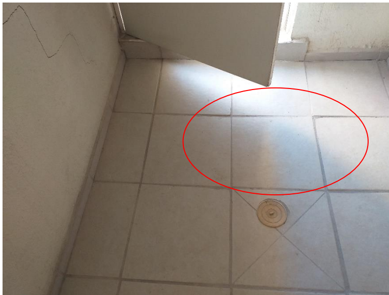
Figura 5 Piso terminado del cuarto de lavado con asentamientos
