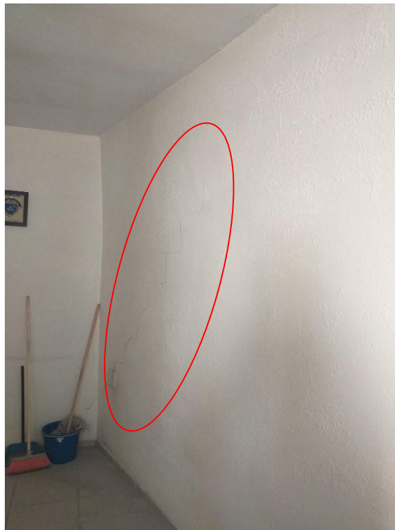
Figura 8 Muro interior de cara oeste del cuarto de lavado, con grietas
