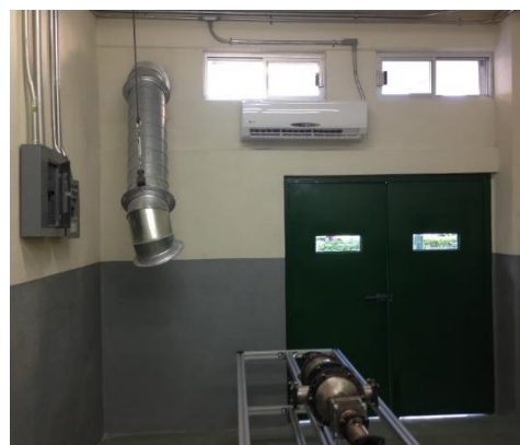
Figura 12. Vista interior del sistema de extracción.
