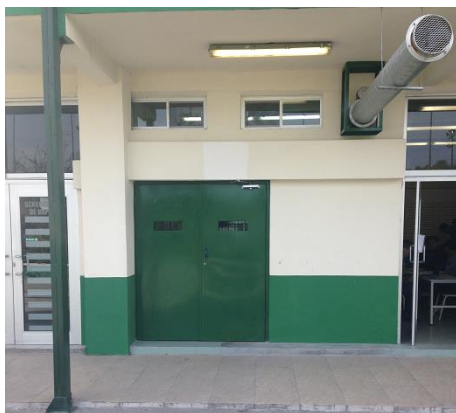
Figura 11. Vista exterior del sistema de extracción.
