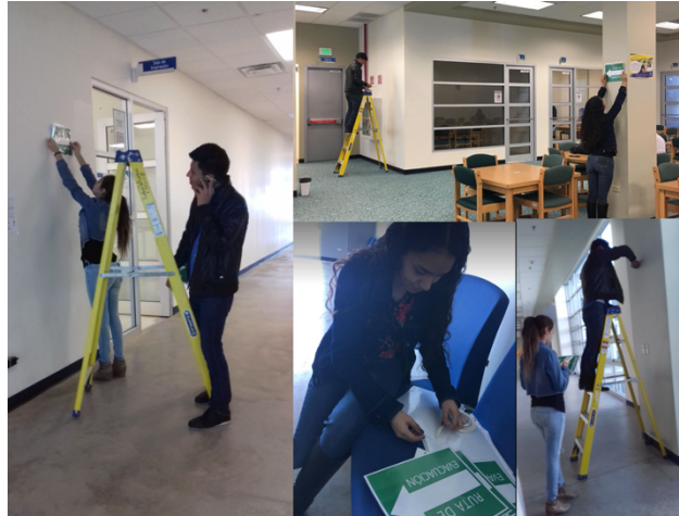
Figura 6. Señalética contra incendios en edificio D.
