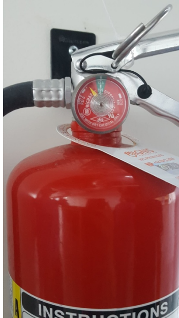
Figura 4. Extintor descargado en edificio D2.
