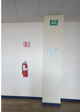
Figura 3. Extintor ubicado en punto ciego.
